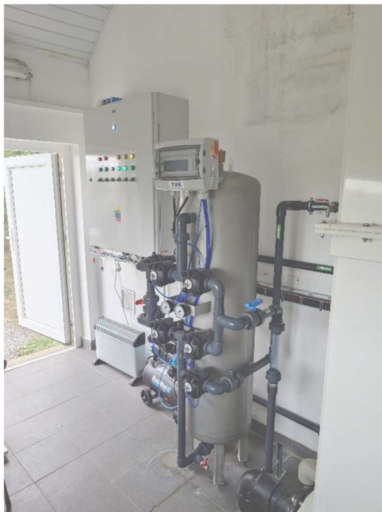
nová filtrační jednotka pro vrt Míchov
